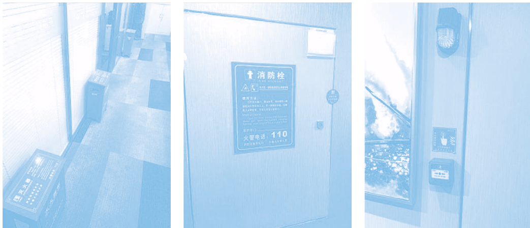
於工作場所的消防安全設備
